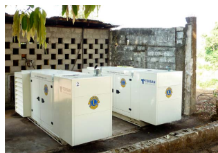
Generatorer til sykehus
